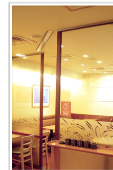
喫煙スペースと非喫煙スペースの境界部に設置された「ブリーズラインユニット」
